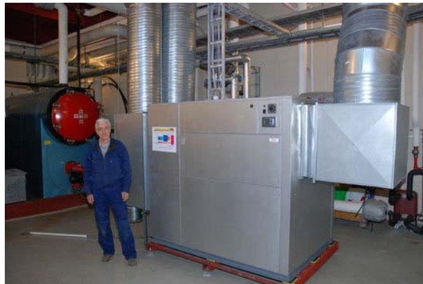
Vaktmester Per Kristiansen med varmepumpen. Pumpen er meget støvsvak og er produsert i Sveits.
